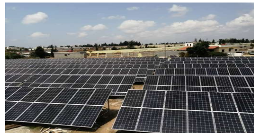
الشكل 1: المحطة الكهروضوئية قيد الدراسة
