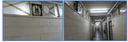
شكل (11): استعمال مفرغات الهواء لتبديل هواء الفضاءات الوسطية بهواء الممرات الداخلية في مبنى الطاقات.
